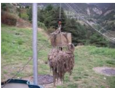
Panier dégrilleur colmaté par des lingettes
