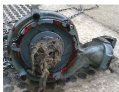
Pompe obstruée par des lingettes
